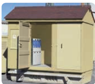
紧凑型FOX-NE在MV/LV变电站
